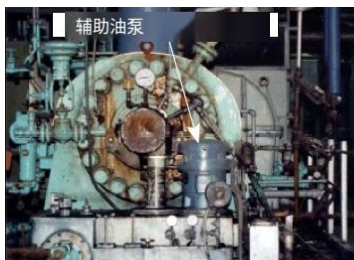
图 5-11: 反应器进料泵，辅助润滑油泵系统
